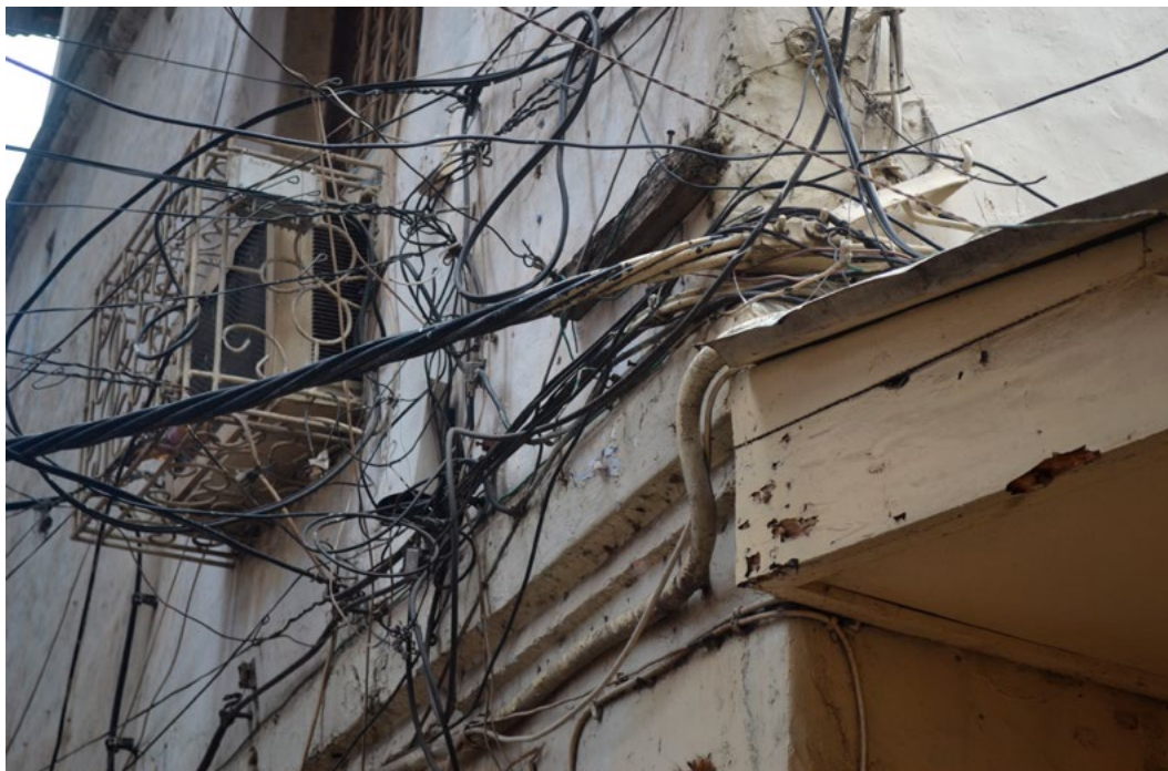
Strømledninger i Stone Town på Zanzibar.
